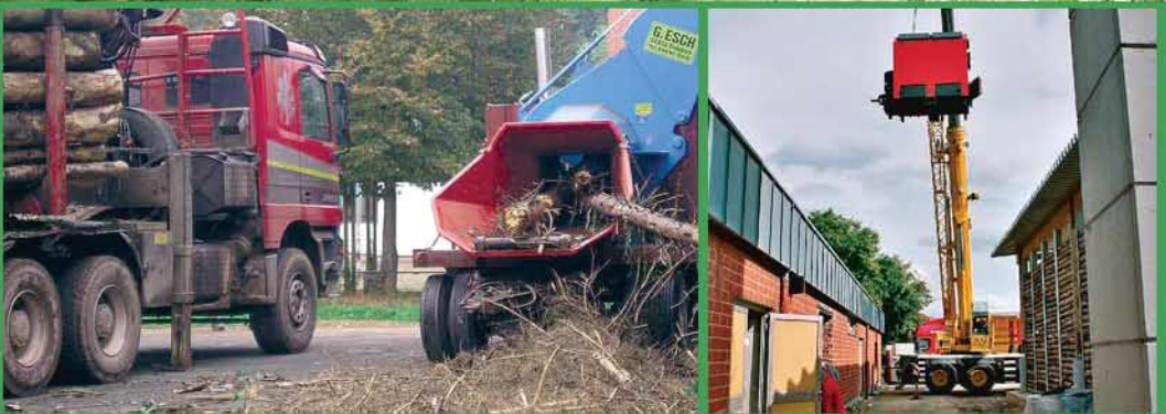
◀ ▲ Holzhacksnitzel-Heizungsanlagen im Schulzentrum Daun und der Regionalen Schule Salmthal mit angeschlossenem Kindergarten und Feuerwehrhaus
